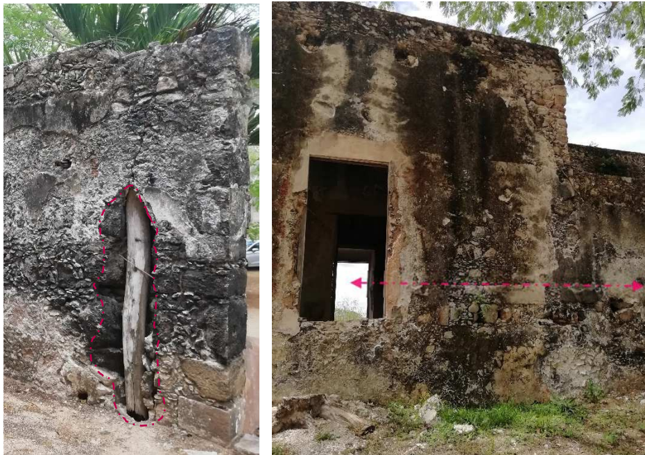
Figura 73. Izq. Evidencia de poste de madera, que probablemente sostenía parte de una cubierta de paja. Se puede observar que posteriormente fue tapiado para dar lugar a nuevos paramentos que resguardarían los nuevos espacios. Der. Huellas de sillares que formaba parte del pretil que cerdeaba el basamento. Fotografías: Autor, 2019.
