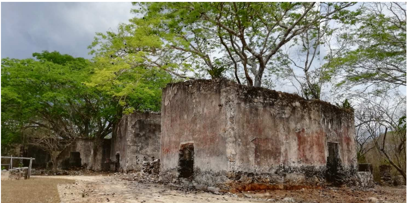
Figura 56. Vista frontal de Casa de Maquinas. Fotografía: Autor, 2019.
