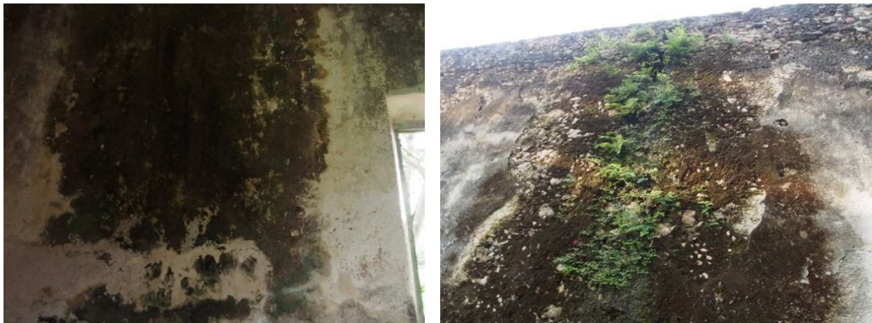
Figura 77. Detalle de presencia de microorganismos, disgregación de morteros, etc. Fotografías: Autor, 2019.
