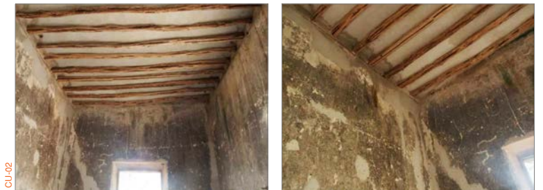
CU-02 | FILTRACION DE HUMEDAD EN PLAFONDES, COLONIZACION BIOLÓGICA Y ATAQUE XILOFAGO EN VIGUERÍA
