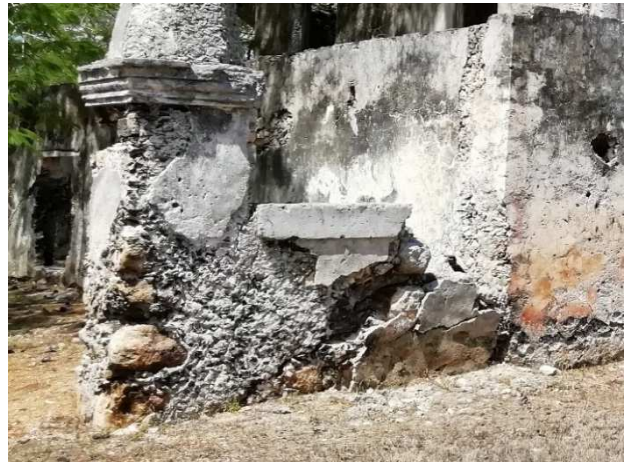
Figura 78. Detalles de fisuras y grietas, fallas estructurales, perdida de elementos, perdida de mortero, etc. Fotografías: Autor, 2019.
