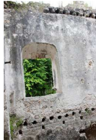
Foto 103. Huecos de vigas y rollizos en losa de entrepiso de camarín, en losa de azotea se observan huecos de rollizos. Foto: LAR, enero 2018
