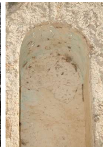
Foto 118. Restos de pintura en nicho de fachada principal. Foto: EJGV, noviembre 2017
