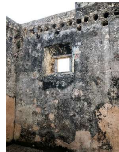
Foto 104. Huecos que indican la presencia de vigas y rollizos en capilla bautismal. Foto: LAR, noviembre 2017
