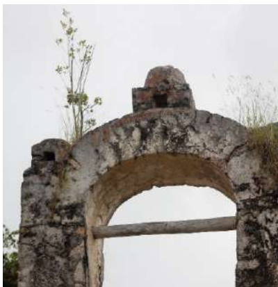
Foto 115. Restos de pintura en elemento decorativo en remate de espadaña de fachada principal. Foto: EJGV, noviembre 2017
