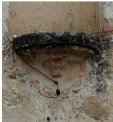
Foto 116. Restos de pintura en relieves decorativos bajo repizón de nicho de fachada principal. Foto: EJGV, noviembre 2017
