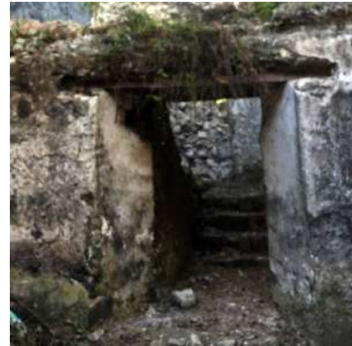
Foto 14. Dintel de madera en acceso a planta baja de camarín. Foto: LAR, noviembre 2017
