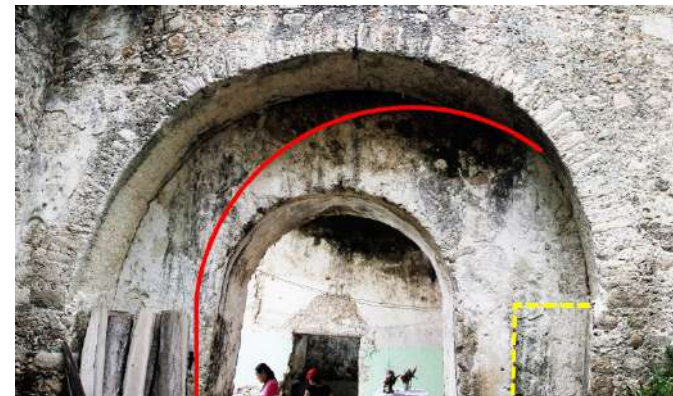
Foto 564. Evidencias de arco primigenio tapiado, así como vano indicado en línea punteada. Elaboración propia, foto: EJGV, noviembre 2018
