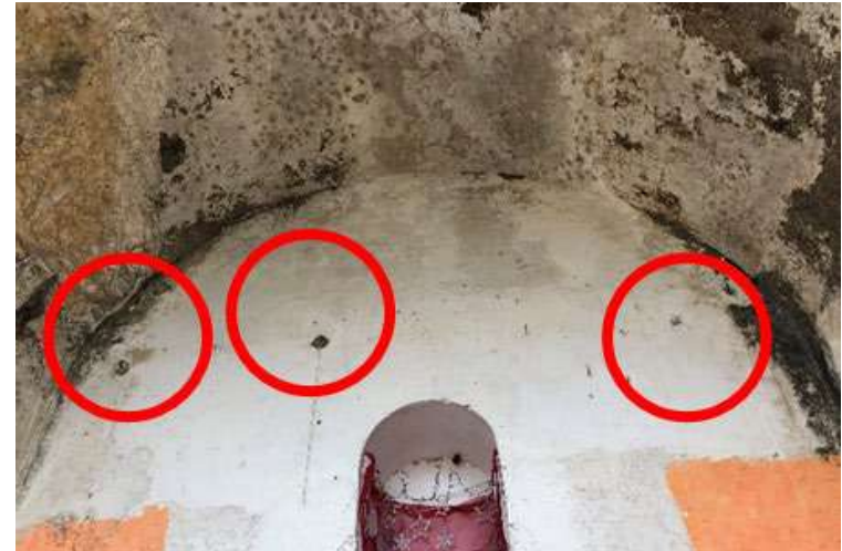
Foto 18. Pedazos de madera incrustados en muro, posible estructura de retablo destruido. Foto: LAR, enero 2018.
