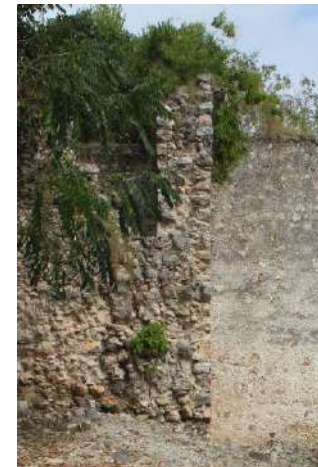
Foto 6. Muro bautisterio, se observa la doble hoja y núcleo. Foto: EJGV, noviembre 2017
