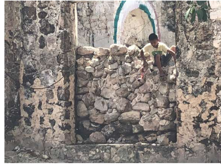
Foto 123. Niño trepando por el tapiado colocado en acceso lateral de la Capilla. Foto: LAR, marzo 2018
