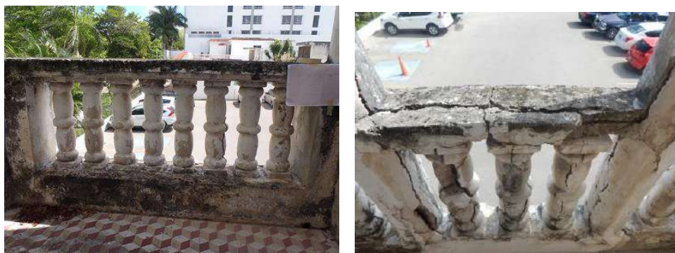
Ilustración 64 Detalle de Balaustradas y sus deterioros
