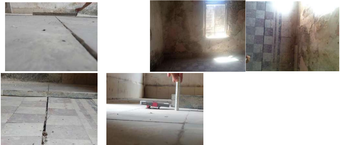
Ilustración 72 Detalles de grietas en piso casa 2
