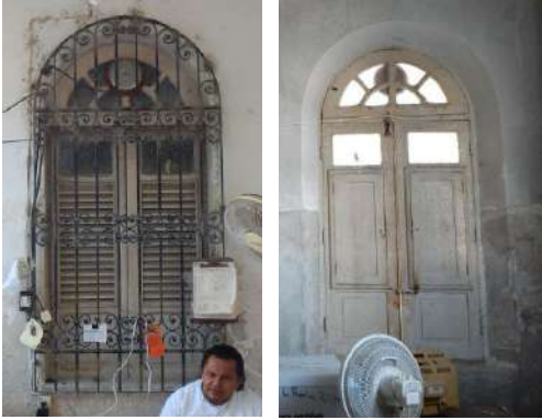
Ilustración 46 VENT 1 EXTERIOR E INTERIOR
