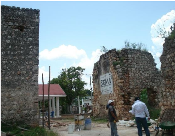
Foto 61. Colapso de muros y cubiertas en los anexos
