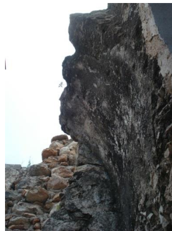
Foto 64. Colapso del arco de un nicho
