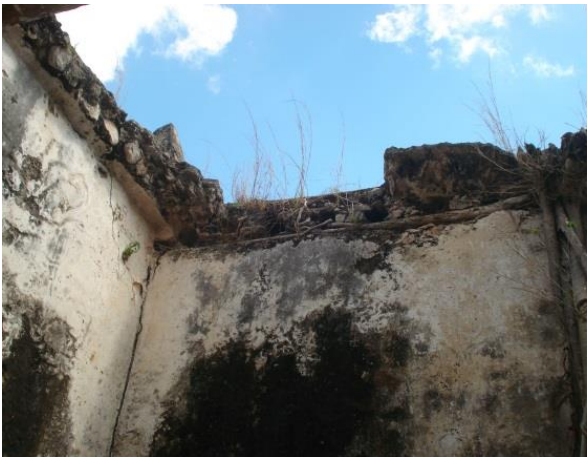
Foto 57. Fisura en la planta alta del camarín
