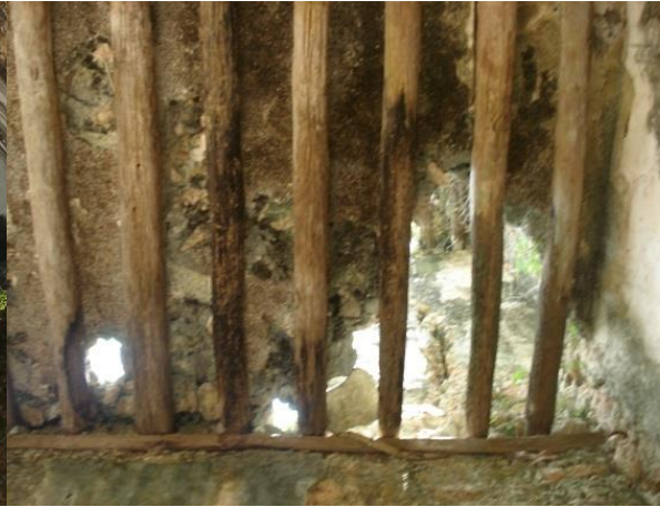
Foto 60. Camarín, colapso de una sección del entrepiso
