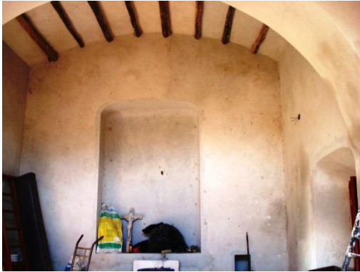
Foto 41. Interior de la capilla, se observan humedades
