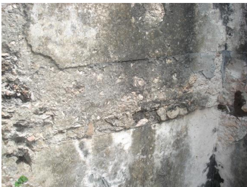
Foto 43. Erosiones en el muro del camarín
