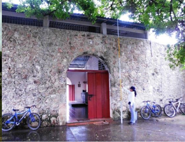
Foto 52. Microorganismos en lo muro lateral sur del templo
