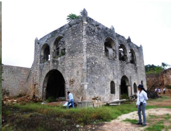
Foto 50. Plantas en coronas de muros, moho en muros
