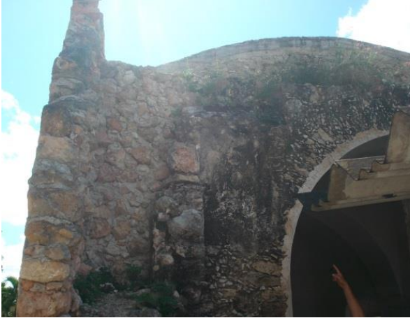
Foto 43. Desagregación de aplanados
