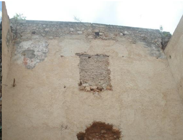
Foto 62. Colapso de cubierta del presbiterio original
