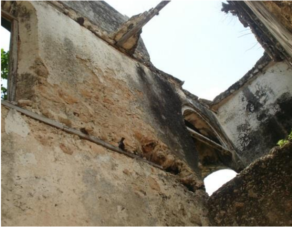
Foto 59. Camarín, colapso de losas y entrepisos
