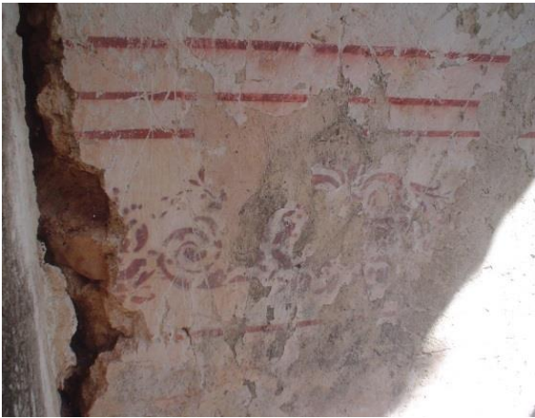
Foto 45. Desprendimiento de pintura estencil en el camarín
