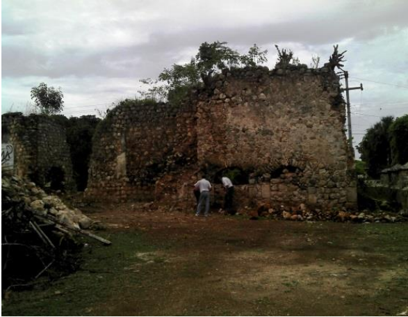
Foto 51. Anexos, se observa arbustos en las coronas de los muros y microorganismos en los muros.
