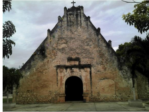
Foto 42. Fachada principal, presenta humedades y ostras de moho
