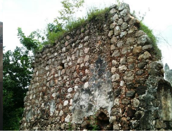
Foto 44. Desagregación de aplanados en anexos
