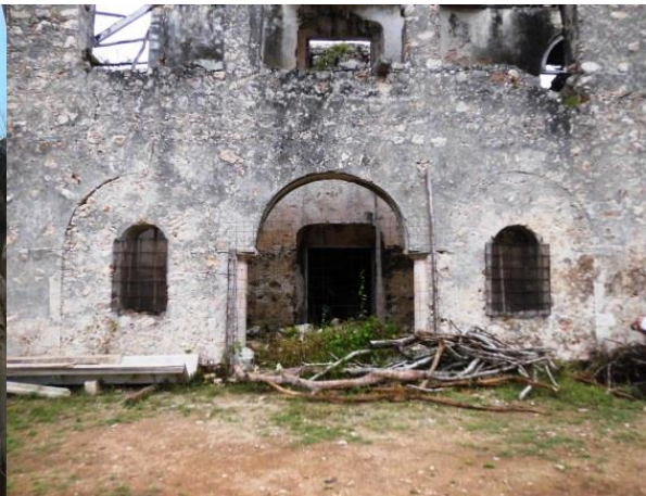
Foto 58. Fisuras en la fachada oriente del camarín
