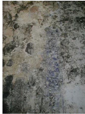
Foto 46. Desprendimiento de pintura estencil
