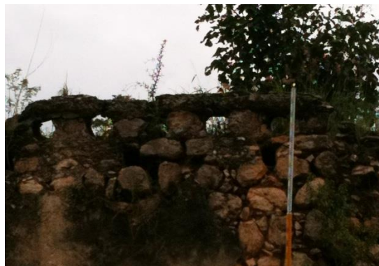
Foto 40. Evidencia de bahpec y rollizo de madera.
