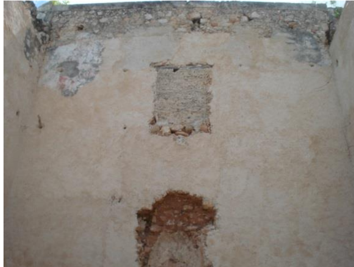
Foto 33. Presbiterio sin cubierta.
