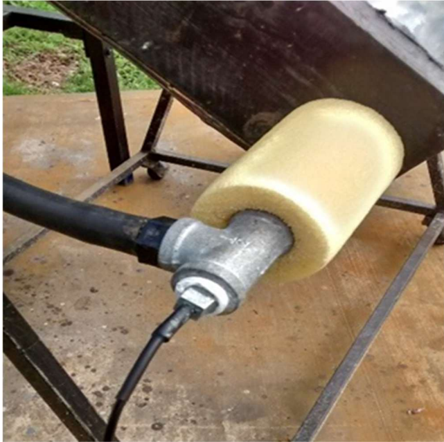
Figura 7. Instalación del sensor de temperatura
