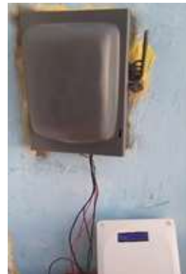
Figura 6. Verificación del sistema de medición
