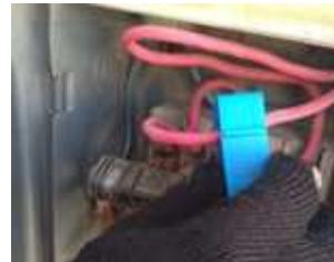
Figura 5. Colocación de los sensores SCT-013 a la línea 1
