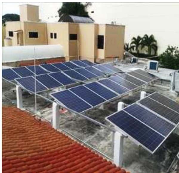
Figura 3.1.1: Arreglo de módulos solares fotovoltaicos.
