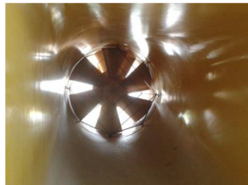
Figura I.V. Zona de ventilador (vista interior).
