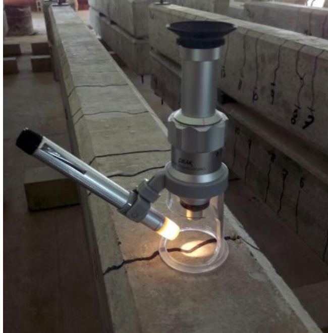
Figura 3.24 Medición del ancho de grietas en traves de CR con microscopio
