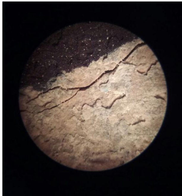
Figura 3.25 Vista de grieta medida con el microscopio
