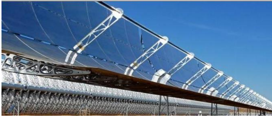
Figura 1. Imagen de un colector de canal parabólico.
