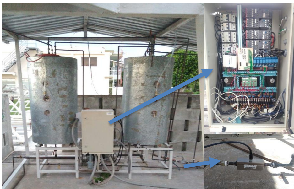
Figura 29. Tanques de almacenamiento con gabinete para sistema de adquisición de datos.
