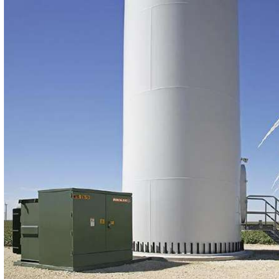
Figura 2.13. Transformador de pedestal para turbina eólica [37]
