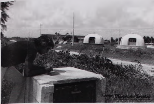
Imagen No. 2 Momento de construcción del conjunto. En primer plano Ricardo Gutiérrez López, inversionista y director de la institución.
