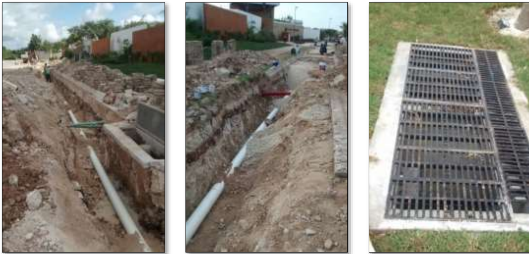
Figura 23. Drenaje sanitario y pluvial convencional; el sanitario conectado al municipal. (Fotografías propias).
