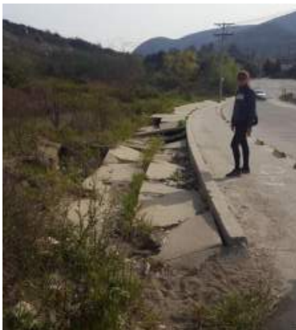
Figura 34. Situación actual de aceras en la prolongación de avenida Ruiz Fuente: Autor (2018)
